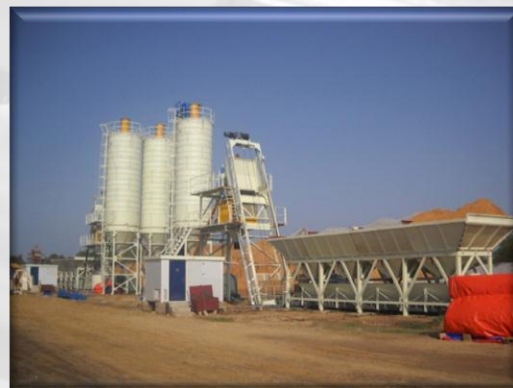
Скиповый бетонный завод
